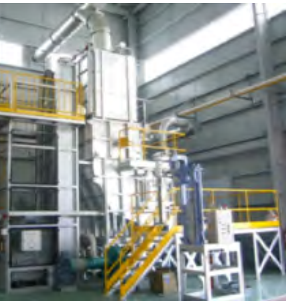
Horno de Fusión en Torre o Stack
